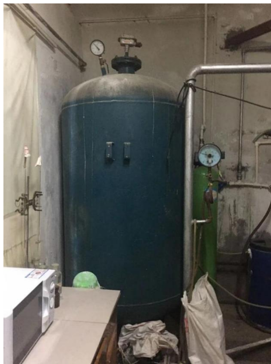
锅炉原供水除氧装置
