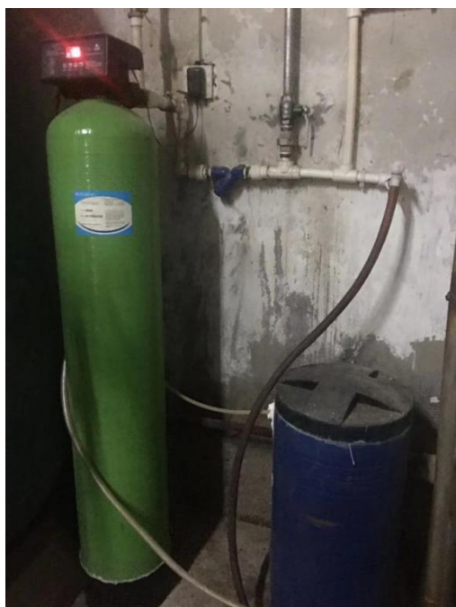
锅炉原供水软化装置
