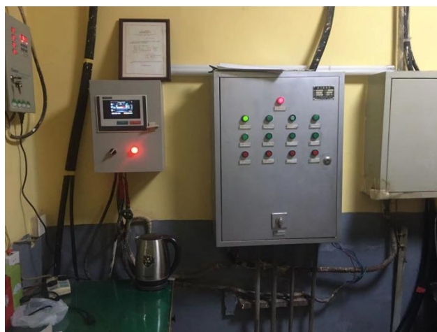
锅炉原控制台
